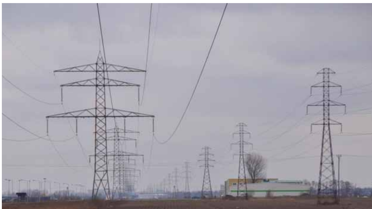
Ryc. 4.2. Okolice m. Sokołów koło Warszawy. Od lewej do prawej: dwutorowe napowietrzne linie elektroenergetyczne o napięciu 220 kV i 110 kV oraz, „poprzecznie” do nich jednotorowa linia o napięciu 15 kV.
