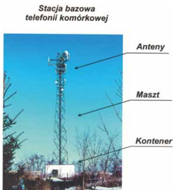
Ryc. 4.12. Typowa stacja bazowa telefonii komórkowej i jej elementy.
