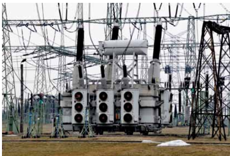
Ryc. 4.9. Duży transformator na stacji elektroenergetycznej.
