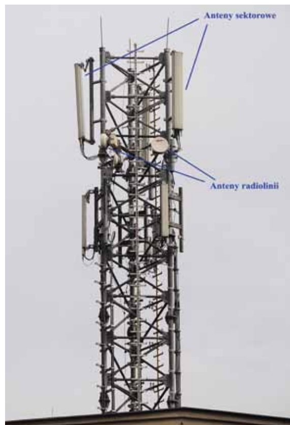
Ryc. 2.2. Anteny sektorowe i anteny radiolinii widoczne na konstrukcji wsporczej stacji bazowej telefonii komórkowej
