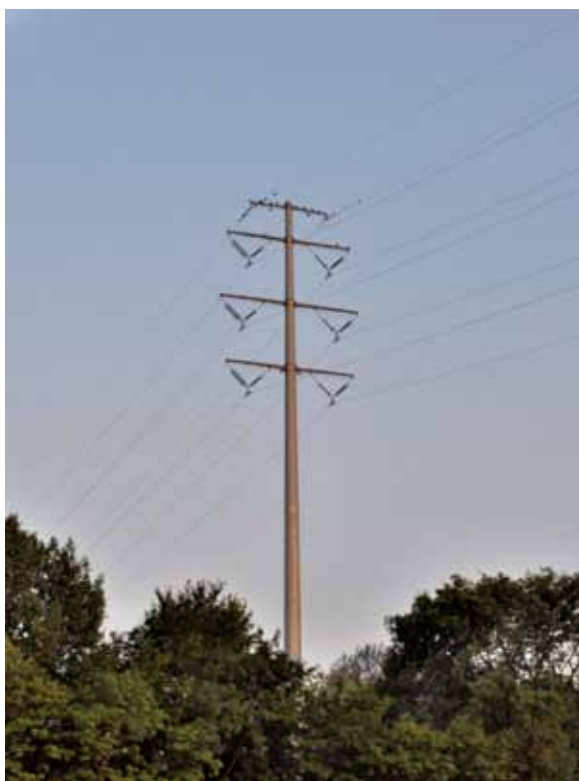
Ryc. 4.4. Dwutorowa napowietrzna linia elektroenergetyczna o napięciu 110 kV na słupach rurowych.
