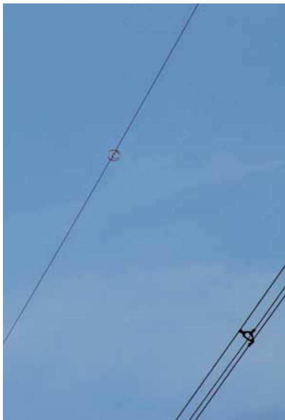
Ryc. 4.6. Okolice Przełęczy Dukielskiej. Dwutorowa napowietrzna linia elektroenergetyczna o napięciu 400 kV w terenie górskim. Kolorowa spirala na przewodzie odgromowym poprawiająca widoczność przewodów linii ogranicza ryzyko kolizji ptaków z przewodami.
